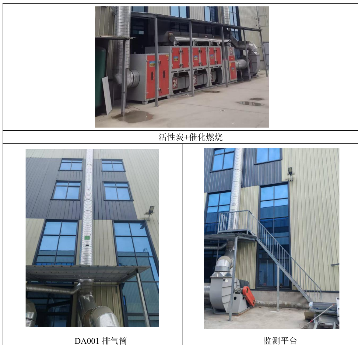
图 4.1-2 排气筒及废气处理设施
