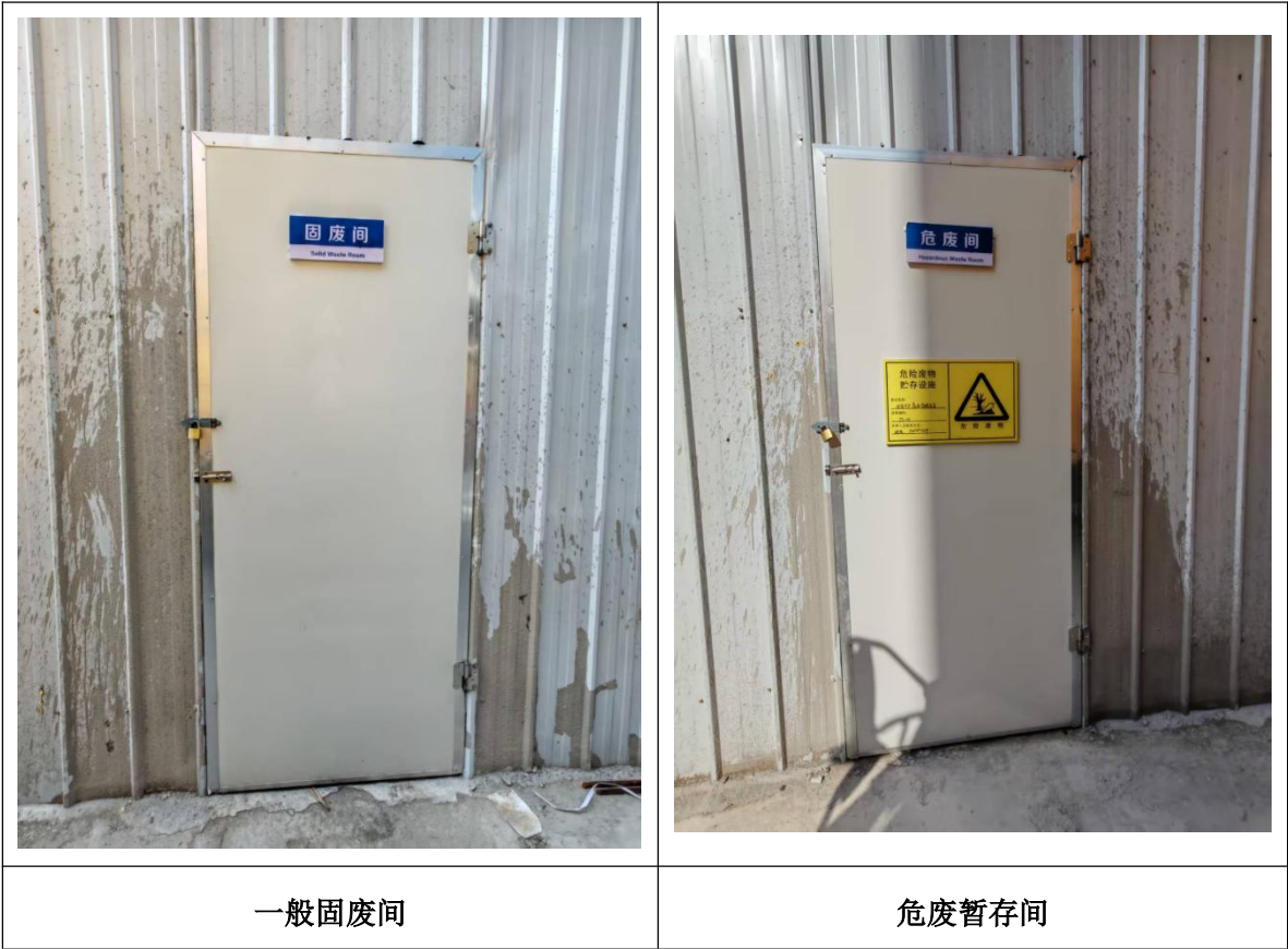
图 4.1-3 固废治理设施
