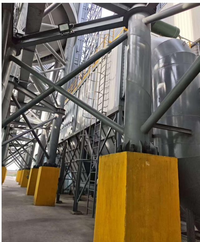
AT005 脉冲除尘器
