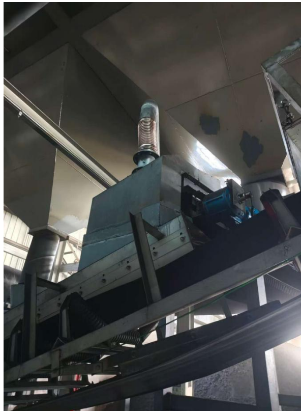
车间废气收集管道
